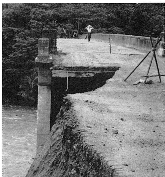
村の玄関坂戸橋の橋台が洗われ自動車通行不能
