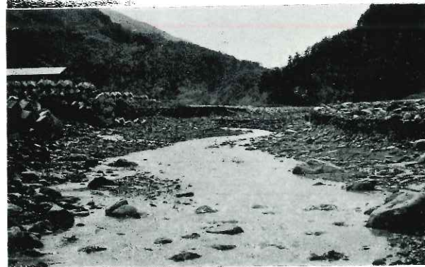
河床洗堀状況
