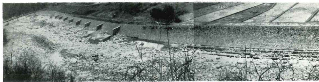
阿智川(屋神)平型十字ブロック破損状況
