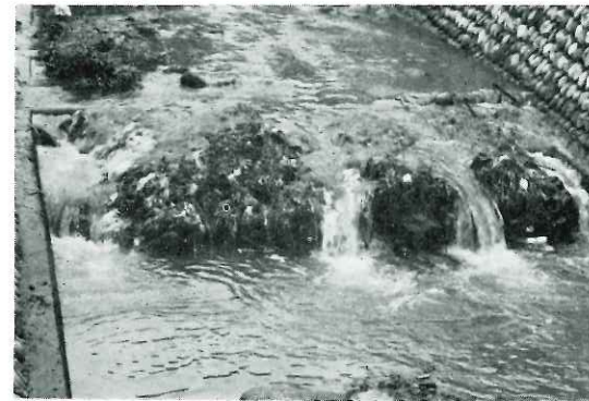
フトン籠破損状況(野底川)
