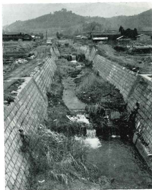
土曾川土砂堆積状況
