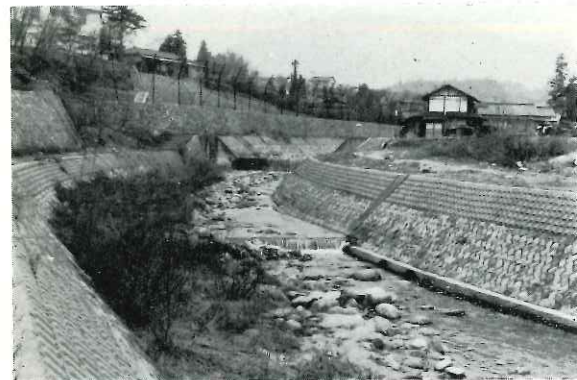
野底川土石堆積状況
