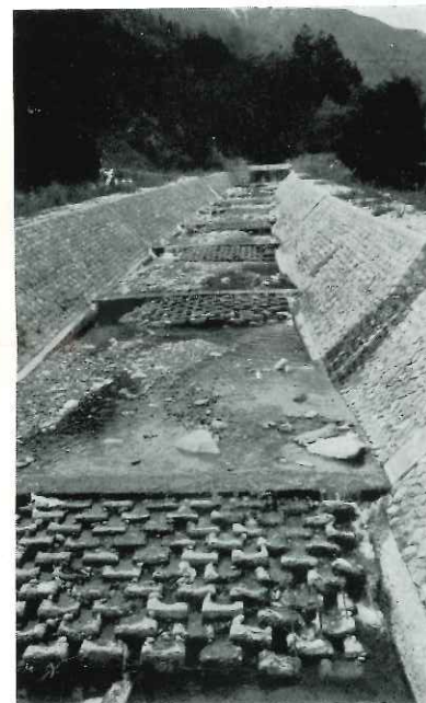
小型ブロックの破損状況(横川川)
